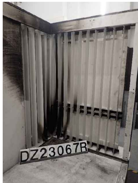
Foto 12: Prüfkörper DZ3.1/23-067R („V-200“), Ansicht nach der Prüfung.
