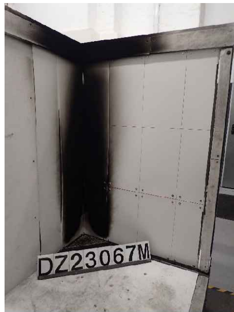
Foto 16: Prüfkörper DZ3.1/23-067M („K-284“), Ansicht nach der Prüfung.
